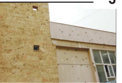
かつての紛争の痕跡(銃痕)が残る学校の外壁。レバノンには老朽化した校舎も多い
